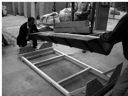
Figure 3. Construction d'un prototype de toiture autoportante en Béton Fibré Ultra Hautes Performances
